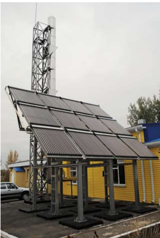
Газовая котельная МБУЗ «ЦРБ» Чертовского района
